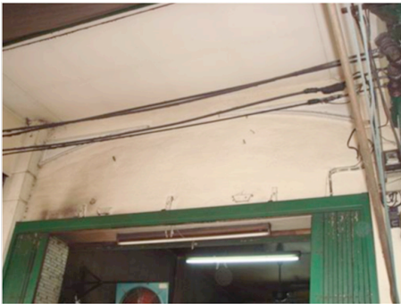
สภาพช่องลมก่อนการบูรณะอาคาร
